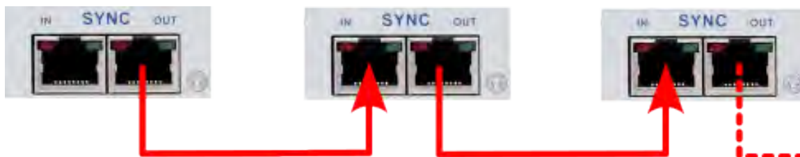
Fig. 15.14: TRION-SYNC-BUS を使用して複数の測定ユニットの同期配線を行います。
